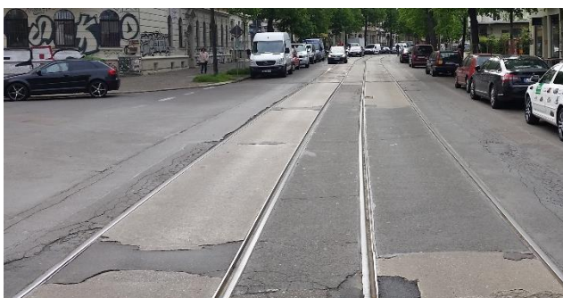
Marode Streckenabschnitte sind häufig der Grund für Langsamfahrstellen und verlängern die Fahrzeiten.
